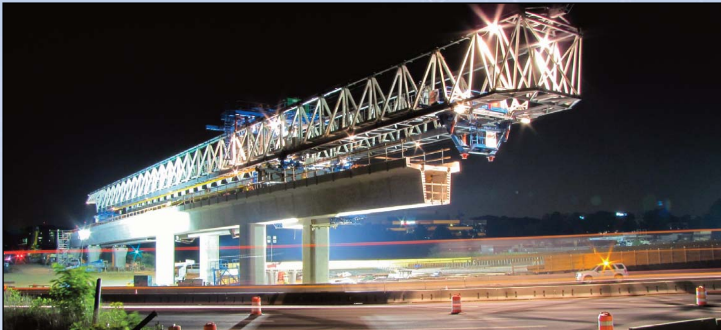
Sobre la I-495: Una grúa horizontal sigue siendo utilizada para construir puentes sobre esta importante autopista de circunvalación de la Capital en Tysons Corner. Foto por Chuck Samuelson, Proyecto del Metrorail del Corredor de Dulles
