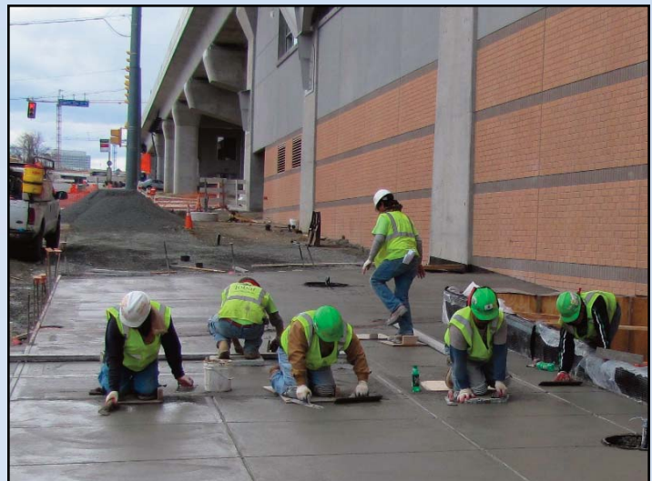
Corriendo para Terminación en septiembre: Equipos pavimentan secciones de Ruta 7 cerca de SAIC mientras la construcción llega a 92%. Foto por Chuck Samuelson, El Proyecto de Metrorail del Corredor Dulles.
