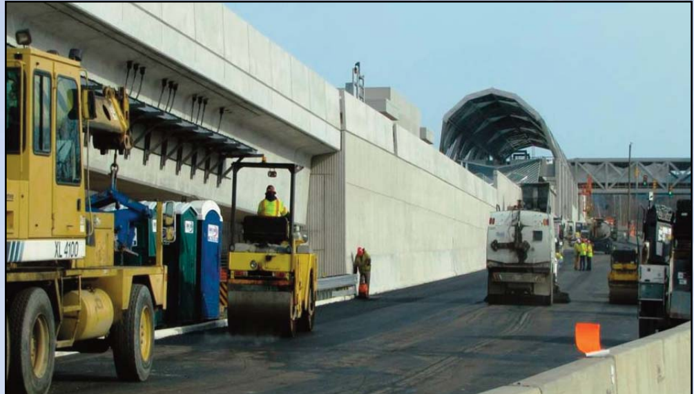
Cambiando Carriles: Los equipos de Dulles Metrorail pavimentan secciones de Ruta 7 cerca de la Estación Greensboro cerca de SAIC y Marshalls. Foto por Chuck Samuelson, El Proyecto de Metrorail del Corredor Dulles.
